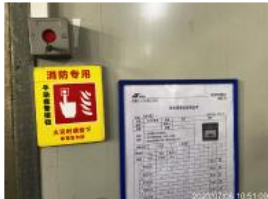
Fire alarm button.JPG
